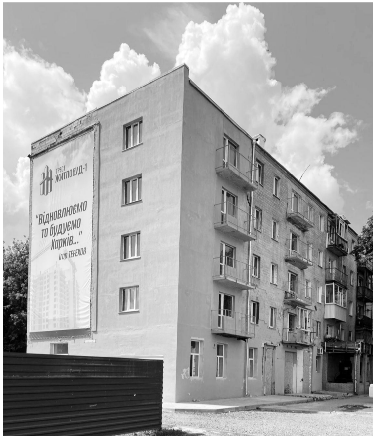
Відновлений трестом «Житлобуд-1» будинок на вул. Холодногірській, 3 уже дав тріщини.
