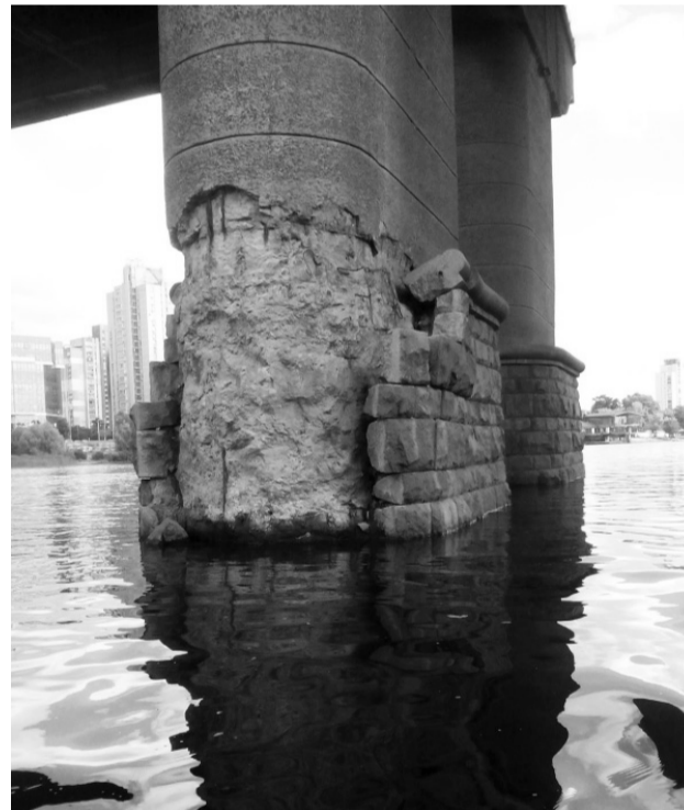
Одна з опор мосту Патона. Стан — катастрофічний.
