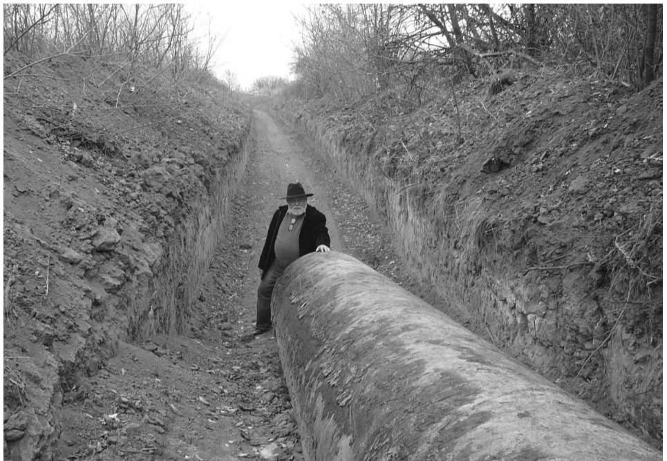
Ось така траншея, вирита злодіями, веде аж до насосної станції. Фото Ганни ЯРОШЕНКО.
